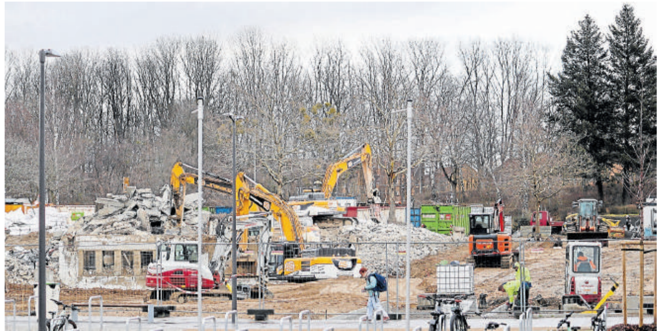
Baggern, was das Zeug hält: Die alte Goldene Aue verschwindet, nebenan sind die Schüler aus den Weihnachtsferien zurückgekehrt und besuchen den Unterricht im neuen Gebäude. Fotos: Epping
